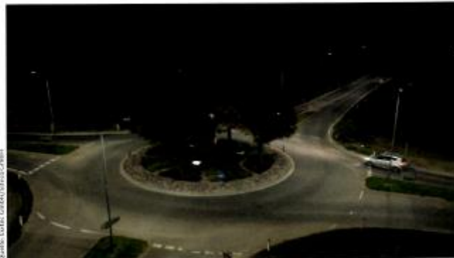
Der Kreisverkehr in Aschbach/Österreich wird ausschließlich dann hell erleuchtet, wenn er befahren wird. Dafür sorgen Radarmodule, die an dem nach unten ausgerichteten Sockel der Laternen befestigt sind.
